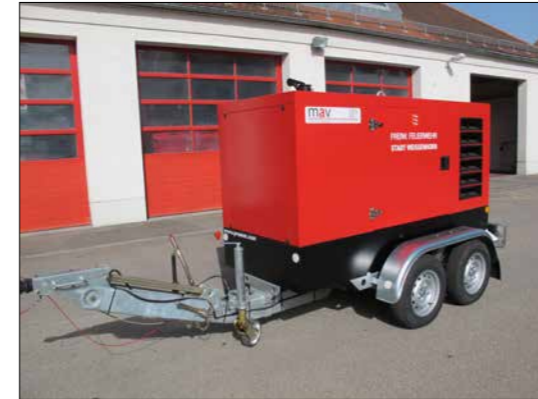
Notstromaggregat 60 KVA, Indienststellung: 2014 Beschafft vom Feuerwehrverein Weissenhorn e.V.
